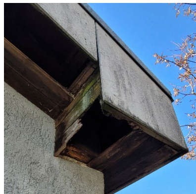
schadhafte Dachuntersicht infolge Wassereinfluss 31.04.2024
