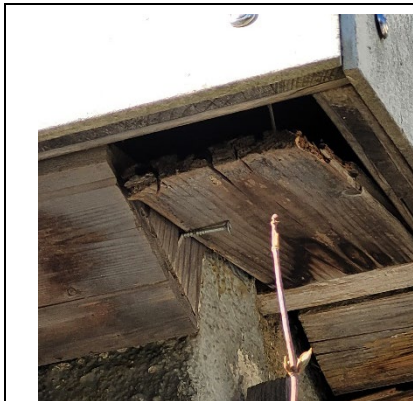
schadhafte Dachuntersicht infolge Wassereinfluss 31.04.2024
